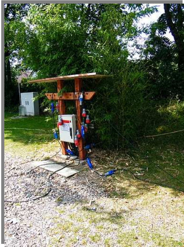
El "árbol" de enchufes del área donde hay que conectar el contador que te entregan en la recepción
